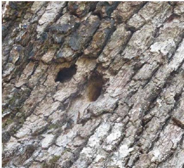
Trous d'émergence du genre Cerambyx sur un gros chêne pubescent attaqué par ces longicornes dans la zone d'étude. Photo prise dans la zone d'étude – ECOTER, 2021
